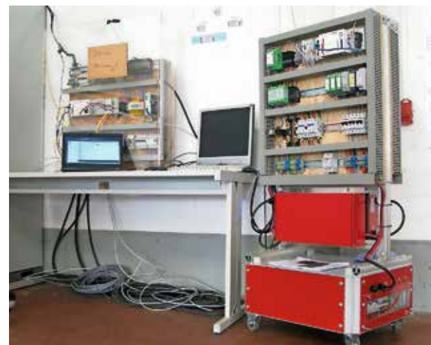
Abbildung 3: Smart-Link-Versuchsaufbau am Institut für Energiesystemtechnik (INES)
