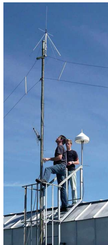
Abb. 1: Aufbau der Antenne für die Monitoring-Station
