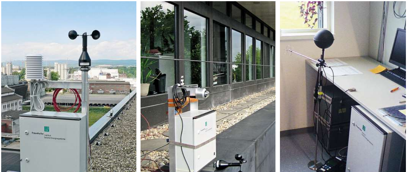
Abb. 1: Mobile Messtechnik zur Datenerfassung, -speicherung und -übertragung von Wetter (links), Mikroklima an der Fassade und Raumklima (rechts). Quelle: Fraunhofer-ISE
