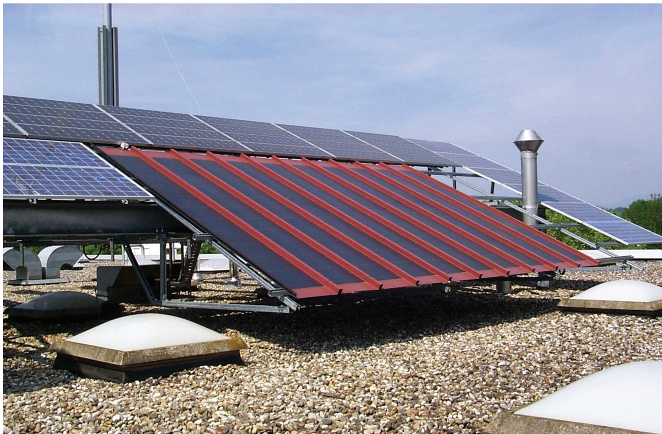
Abb. V.18-2: Generatoren des PV-Teststand
